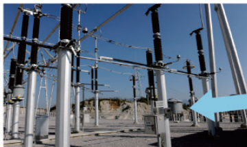
云南500kV变电站
