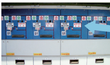
广西配网环网柜
