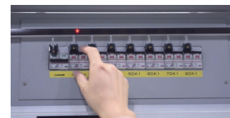
倒闸操作：二次操作
