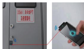
倒闸操作：一次操作
