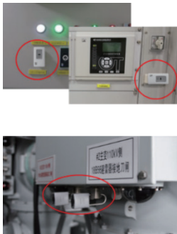
一次设备开关柜闭锁
