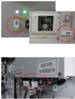
一次设备开关柜闭锁
