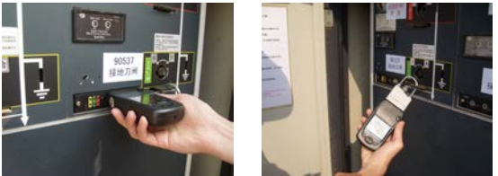
图2 防误闭锁现场应用
