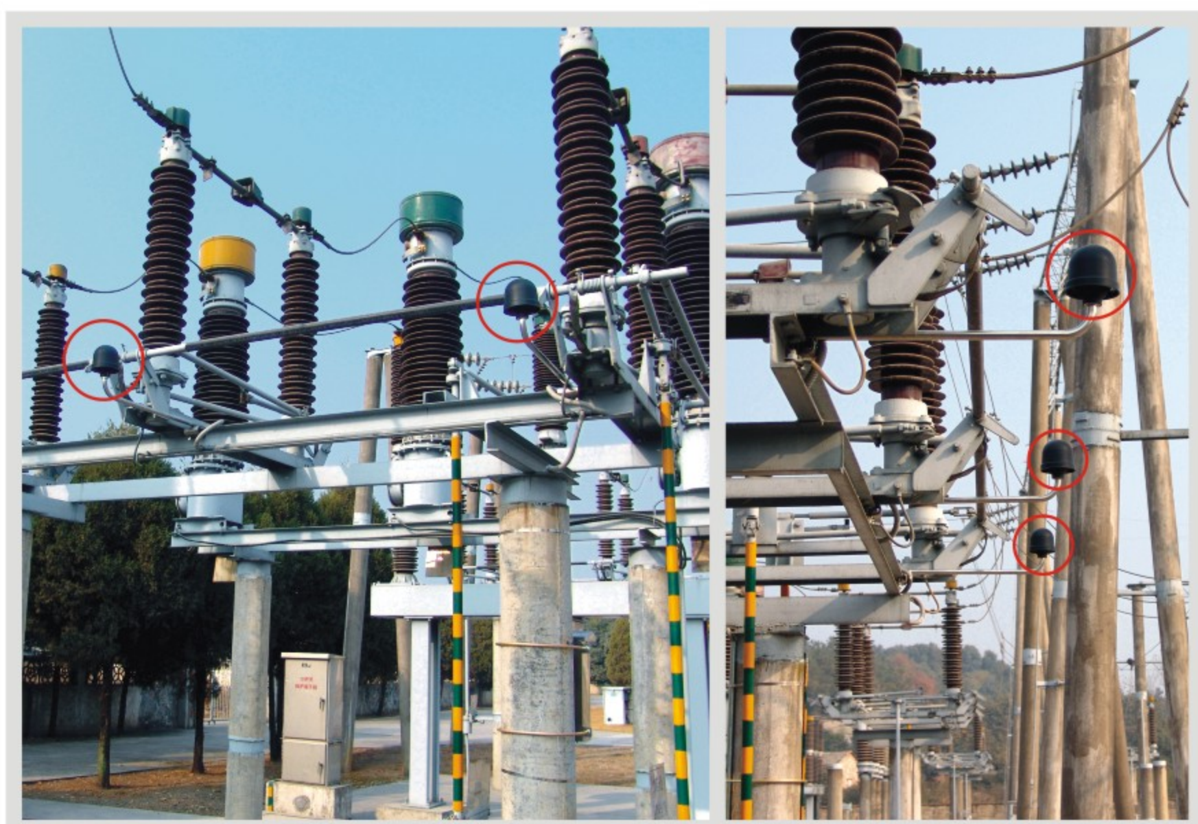
图1 传感器在线路侧的安装（110kV）
